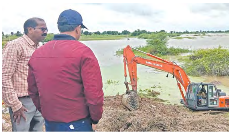
వరద ప్రధానానికి గురైన రైలుమార్గం పరిశీలించుకున్న అధికారులు
